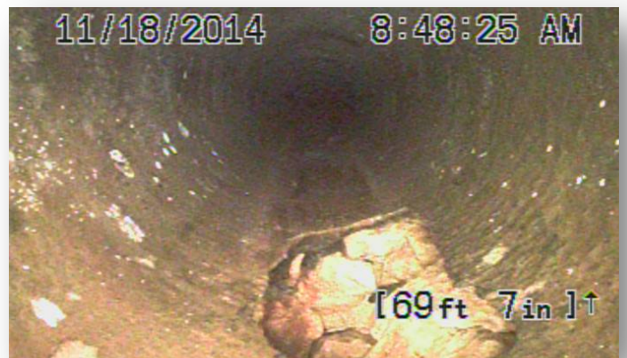
Rotura en la tubería
